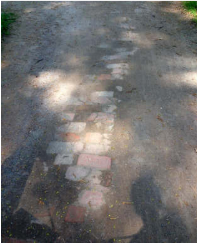
Abb. 47 Weg im Weserlaci. Die Deckschicht der wassergebundenen Wegedecke ist an dieser Stelle komplett abgetragen, die darunterliegende Schicht ist freigelegt. Es handelt sich hier vermutlich um eine ältere Bauweise, die als Tragschicht genutzt wurde Foto, Juni 2018 (L-A-E EHRIG 2018)
