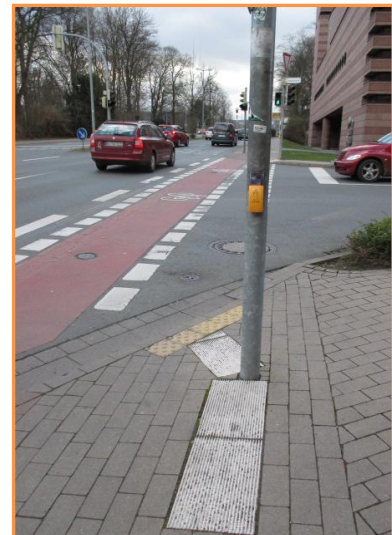
Abbildung 19: Gesicherte Querungsstelle mit falsch ausgerichtetem Richtungsfeld
